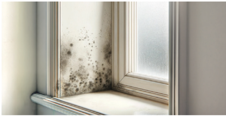
Achtung Schimmel: Schwarze Flecken als Indiz für einen Schimmelbefall (Bild: KI-Generiert)
